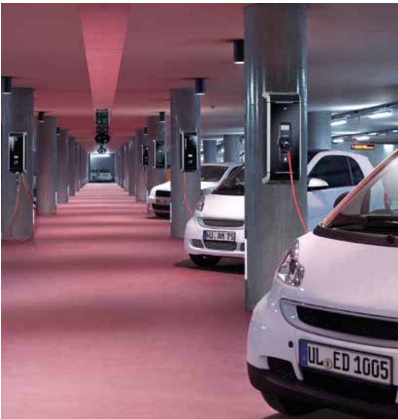
Bild 9: Ladeeinrichtungen für Elektrofahrzeuge in einer Tiefgarage
