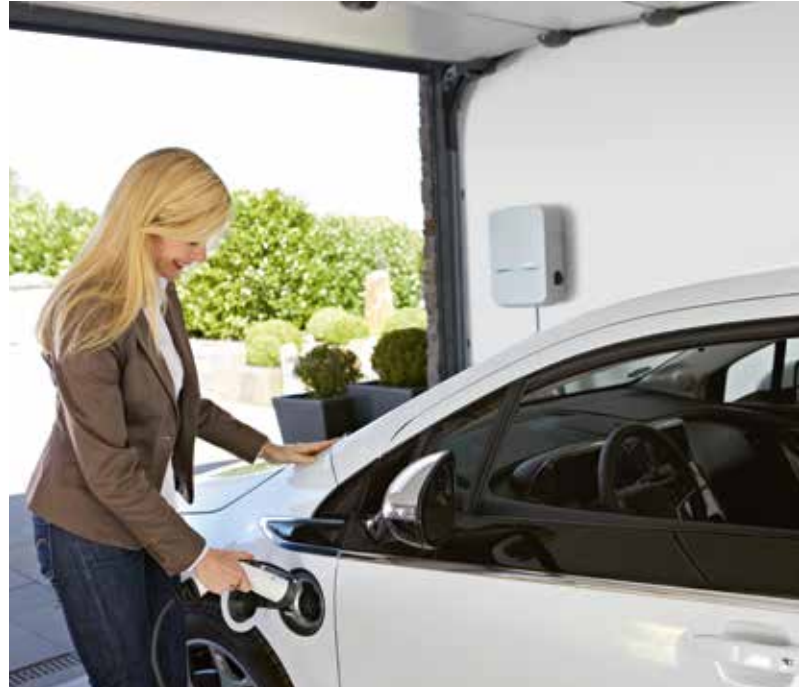
Bild 13: Ladestation in einer Garage
