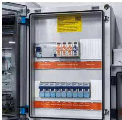
Bild 11: Im Verteiler eingebaute Überspannungsschutzeinrichtung Typ 2
