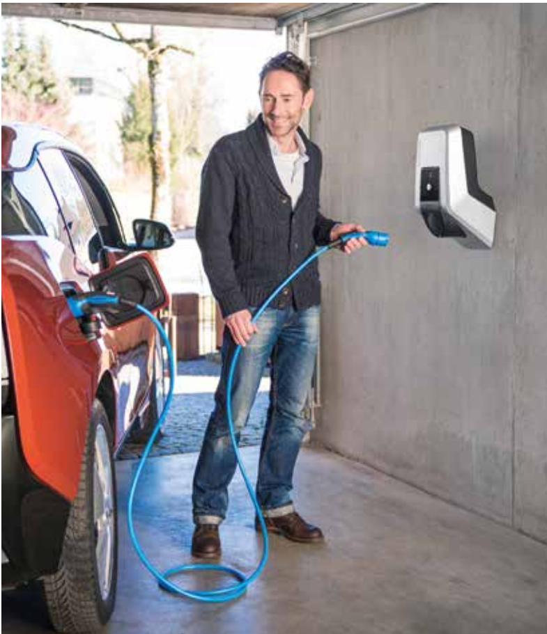
Bild 3: Ladeeinrichtung in einer Garage
