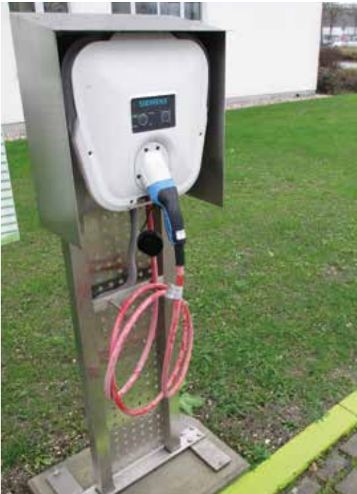
Bild 12: Ladestation im Außenbereich mit Regendach
