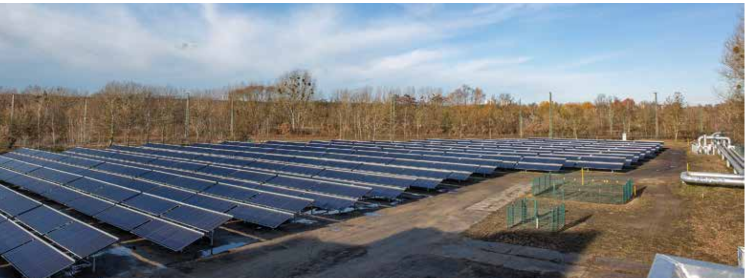
Ein Baustein der Dekarbonisierung in der Fernwärmeversorgung ist die Solarthermie, sichtbar in der 2019 errichteten Freiflächenanlage der EWP in Potsdam-Süd.
